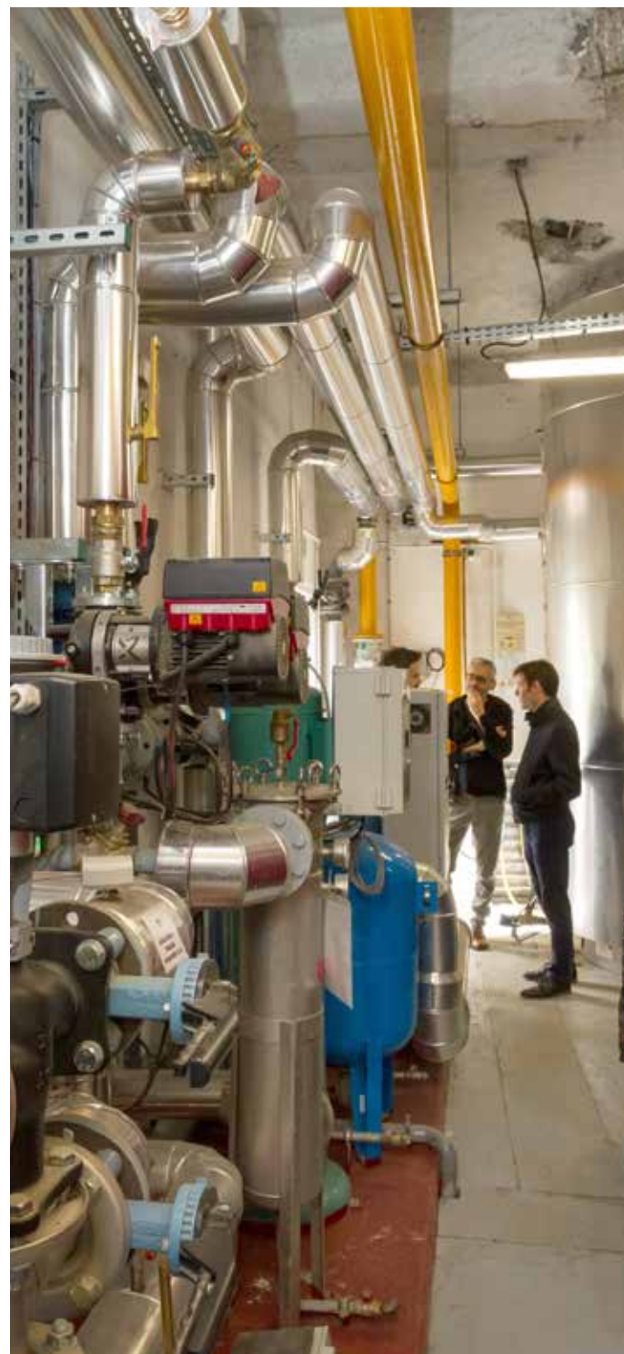
ICF HABITAT LA SABLÈRE - 1 RUE DE GERGOVIE, PARIS 14 E - LA CHAUFFERIE.
